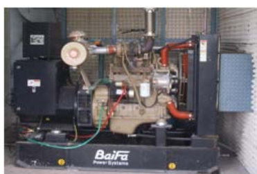
รูปที่ 8 เครื่องผลิตกระแสไฟฟ้าด้วยเครื่องยนต์ดีเซลสันดาปภายในขนาด 50 kW
